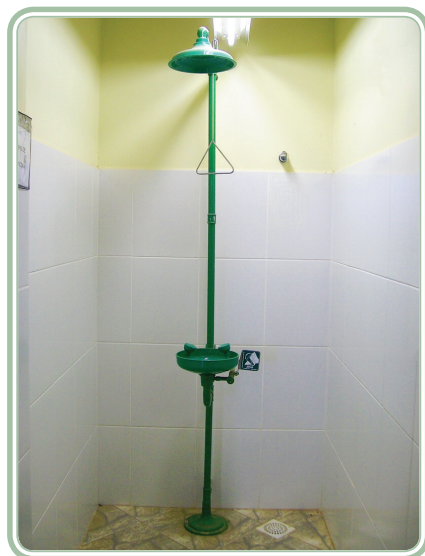
Figura 1.6: Chuveiro de emergência com lava-olhos
